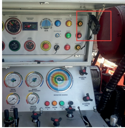
Fotoğraf 1: Kontrol Paneline Yerleştirilmiş Gaz Ölçüm Cihazı
